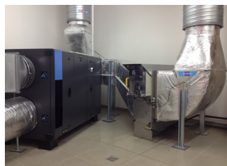
Module adiabatique sur reprise d'une centrale double-flux
